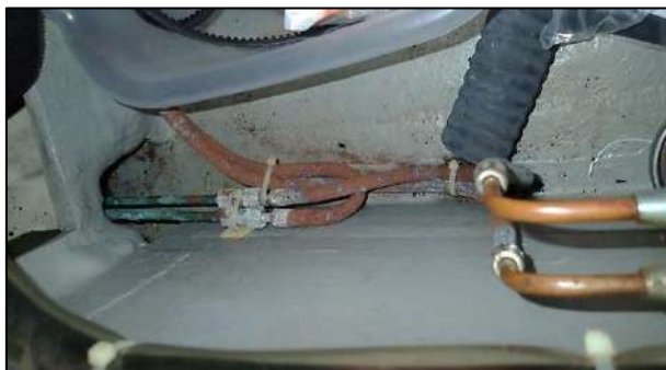
Photo 7 : tuyaux de gasoil corrodés
